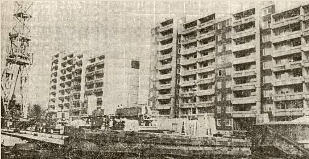
Mit Interesse verfolgen die Hallenser das Baugeschehen in der Innenstadt. Hier am Unterplan sind Bauarbeiter der Takstraße 3 im Einsatz. Sie wollen bis Jahresende insgesamt 115 Wohnungen übergeben und damit ihren Jahresplan mit 8 Wohnungseinheiten überbieten. Foto: Bettina Wiederhold
